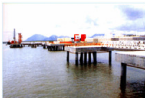
Hình ảnh: Thi công xây dựng cầu tàu - Cảng xuất LPG Thị Vải
