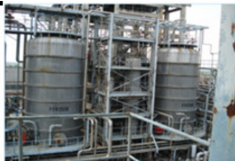
Hình ảnh: Hệ thống Instrument nhà máy TPC Vina
