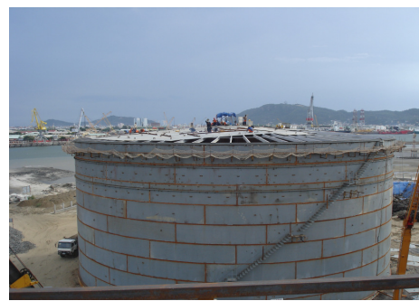
Thi công kéo chế tạo bồn chứa xăng dầu tại công trình kho xăng dầu Cù Lao Tào
