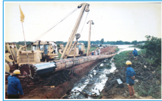
Lắp đặt tuyến ống Xi phông Tân Thuận II qua sông Sài Gòn
